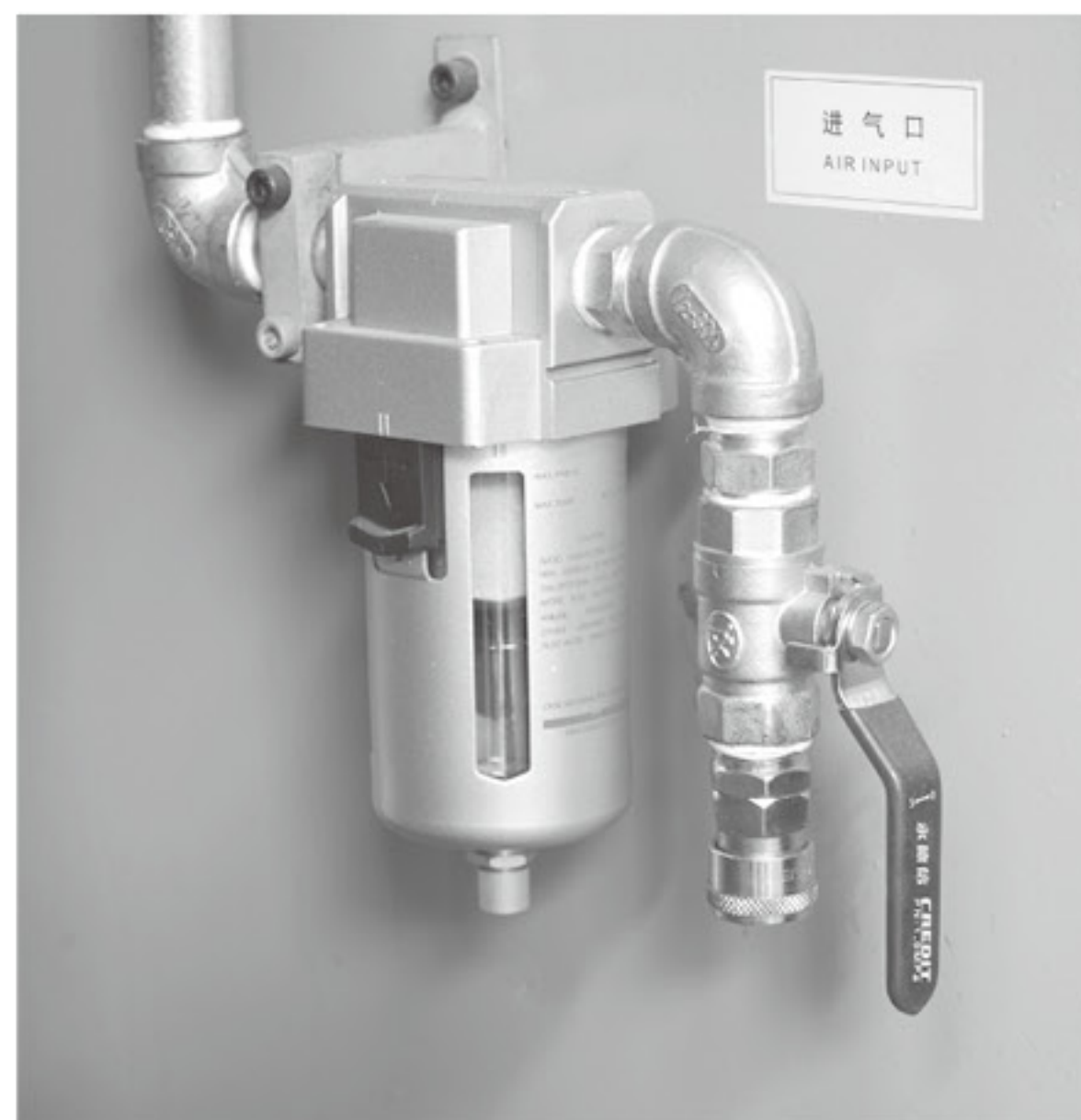
空气过滤器，用于过滤空气中的水份，每天排放一次
